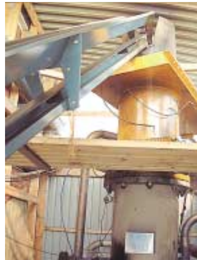
Övre delen av gengasverket där inmatning av träbränslet sker. Exempelvis kan träflis med en fukthalt på upp till 40 % användas utan förtorkning.
