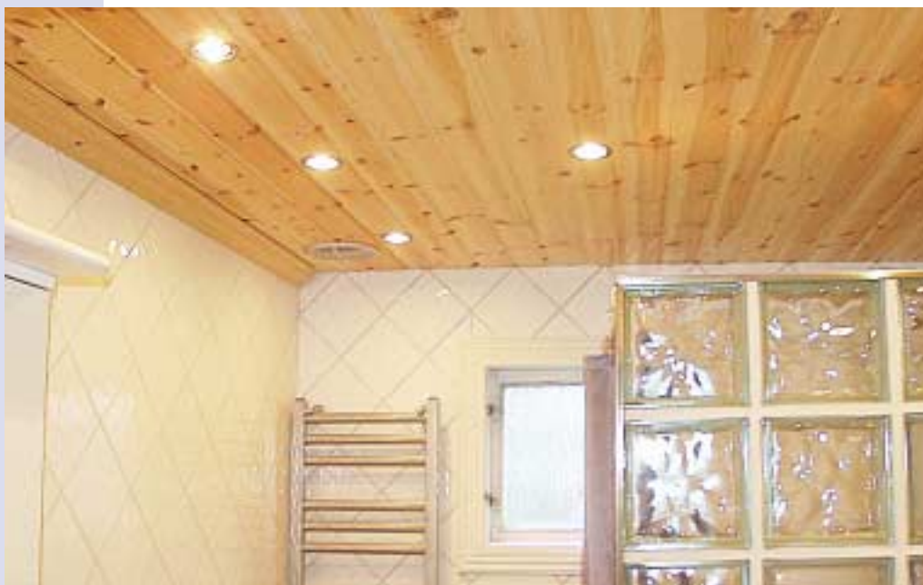
Spotlights är ofta bristfälligt monterade. Kravet på god lufttäthet hos klimatskärmen har då åsidosatts.
